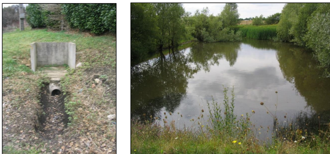
Figure 28 : Puisard au lieu-dit la « Gueule du Val » à Arnières-sur-Iton (à G.) et bassin n°1 de la RN1013 (à D.)
